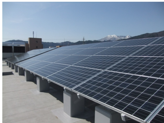
図 2 機械工学科棟屋上（単結晶および多結晶系）
